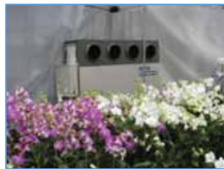
安定的採熱とヒートポンプ利活用
