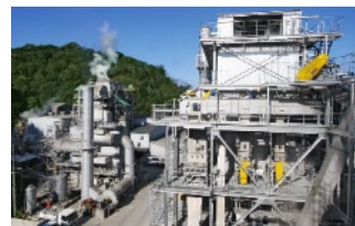
鶏糞燃焼発電ボイラー
